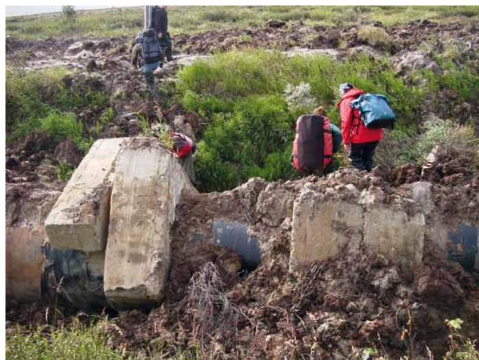
Gazoduc déterré à cause de la fonte de la glace du pergélisol ou permafrost en Sibérie (© A. Kouraev)
